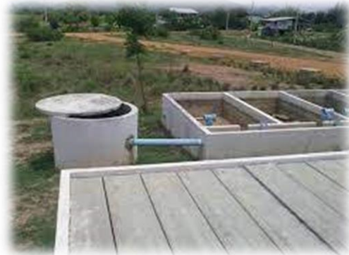
บ่อบำบัดน้ำเสีย
